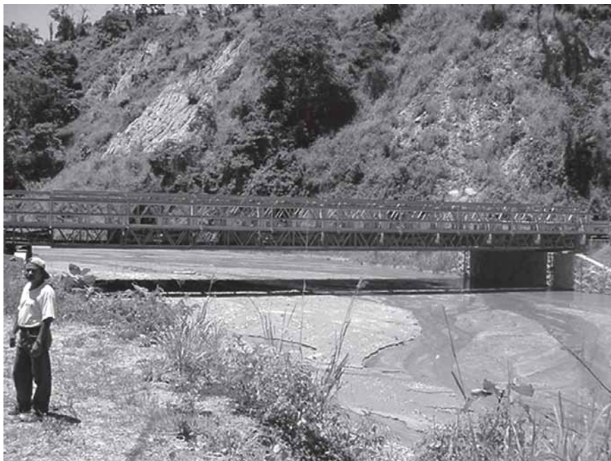
Fig. 4.- Fotografía tomada en el río Desagüe, en la ladera del Ilopango. El puente fue construido originariamente sobre un cauce más profundo ahora totalmente colmatado. Pueden verse al fondo los derrumbamientos producidos por el terremoto de 2001, erosionados y agrandados por las fuertes lluvias de la zona.
