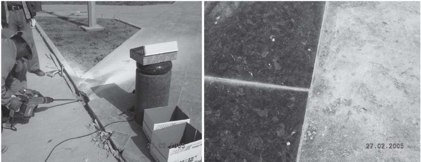
Fig. 1.- a) Toma de muestra de la roca tras la alteración sufrida. b) Detalle del pavimento alterado.
