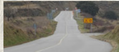
Deslizamiento desplazando a una carretera
