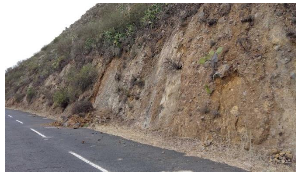
Parada 1. Plano de deslizamiento principal mostrando la brecha de falla y el espejo de falla. Carretera HI-104 de San Andrés a Tiñor.
