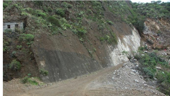
Parada 3. Plano de deslizamiento principal en el Barranco de Tiñor.
